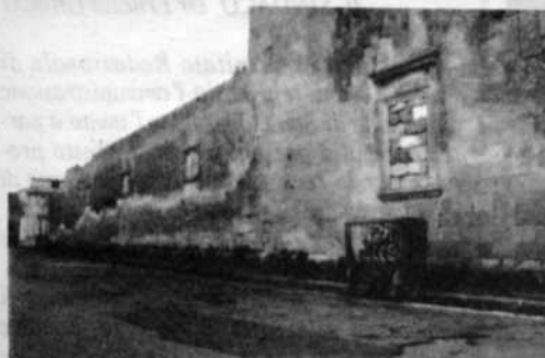
Alcuni esempi di degrado ambientale di estremo squallore. Siamo in pieno centro.
